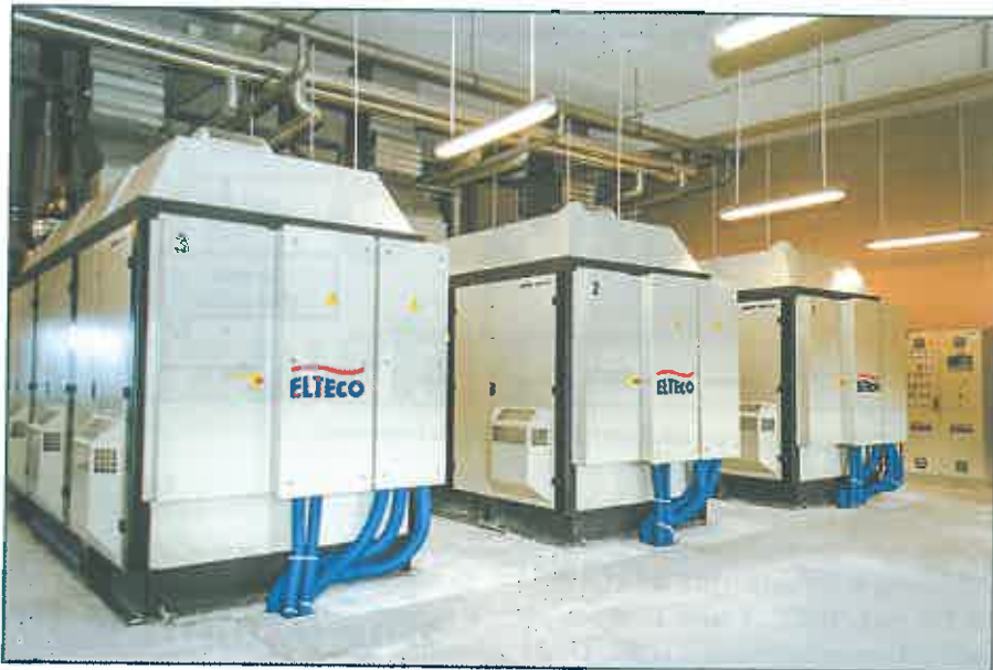
Fot. 3. Agregaty kogeneracyjne Elteco Petra 500C na oczyszczalni ścieków Klimzowiec
