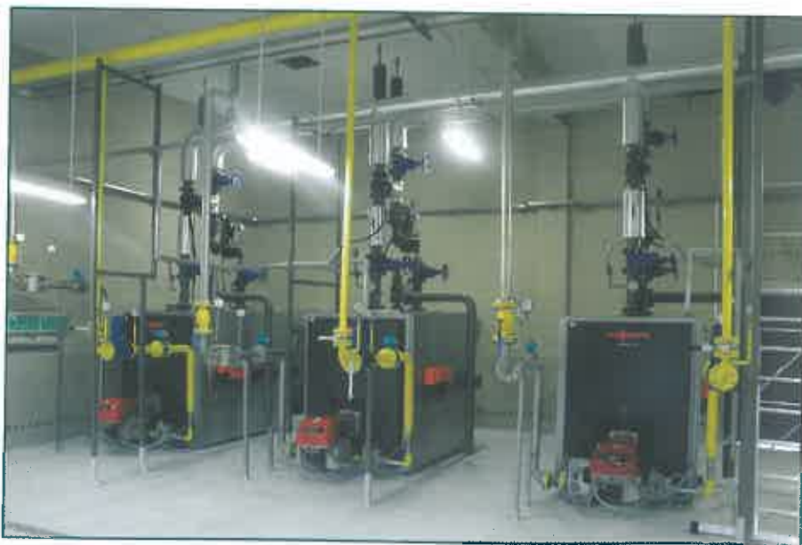
Fot. 4. Kotły dwugazowe Viessmann na oczyszczalni ścieków Klimzowiec
