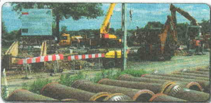
Modernizacja sieci kanalizacyjnej wpłynie na poprawę jej stanu technicznego
