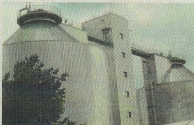
Charakterystyczne generatory umożliwiające pozyskiwanie biogazu
