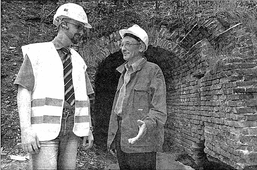
Bartłomiej Jarocha z ChŚPWik oraz Stanisław Kowalski z firmy Energoterm już rozpoczęli prace przy kanalizacji w świętochłowickim Chropczowie.
